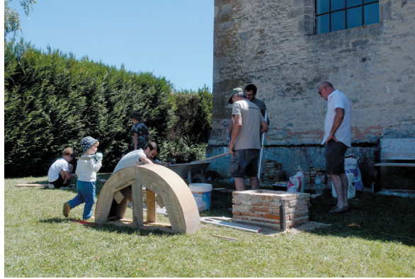
Chantier participatif de la construction de la voûte devant l'église de Morvilliers. 2 juillet 2022. Photo : ADH.
