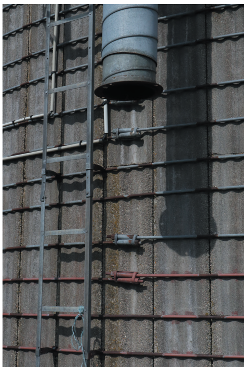
Détail d'un silo à grain à l'abandon. Juzanvigny, mai 2022. Photo : ADH.
